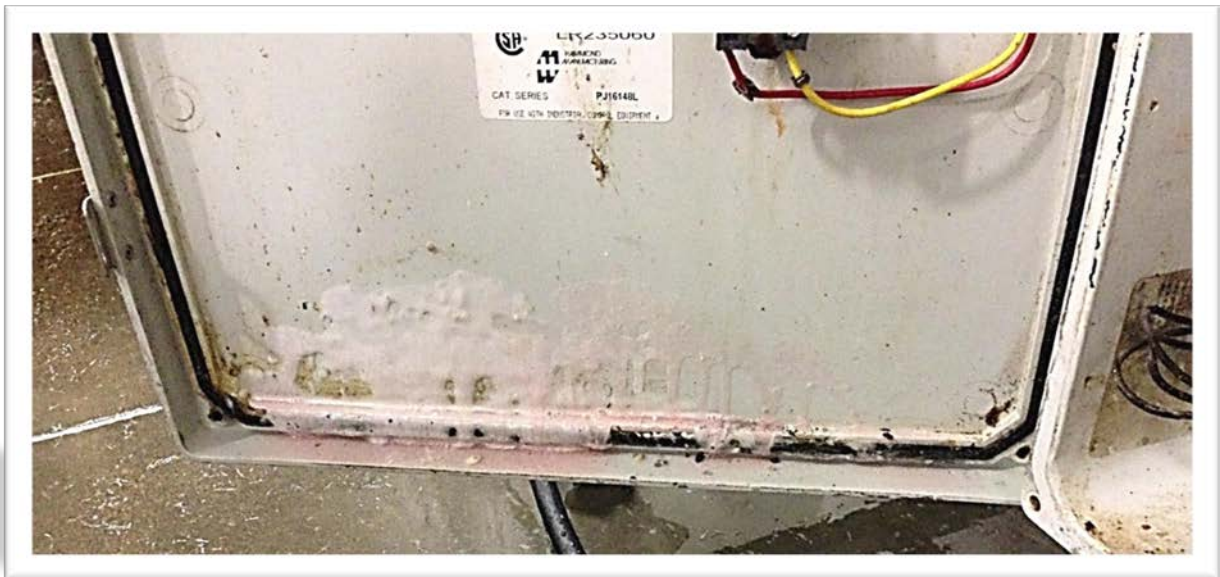
Electrical Panel Panneau électrique
